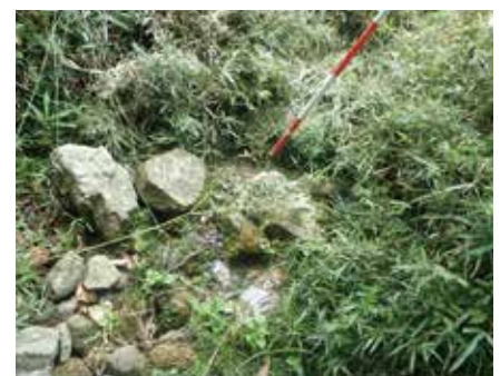
法尻部からの漏水も草刈りが適正にされていたら、すぐさま発見することが出来る
