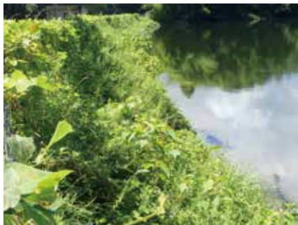
堤体上流法面は草だらけで地表面がわからなくなっている
