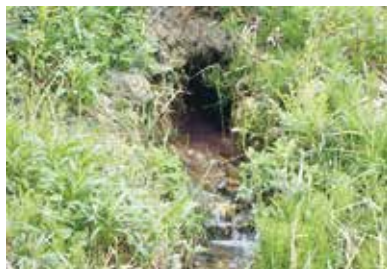
ため池からの漏水状況
