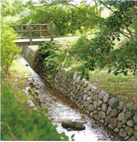
ため池泥吐ゲートも改修され、用水路は美しい景観を保っている
