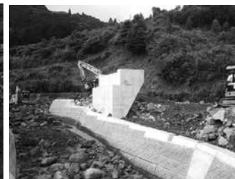
降雨後土砂体積状況
