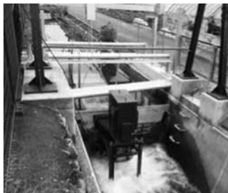
小水力発電施設「彦電」
