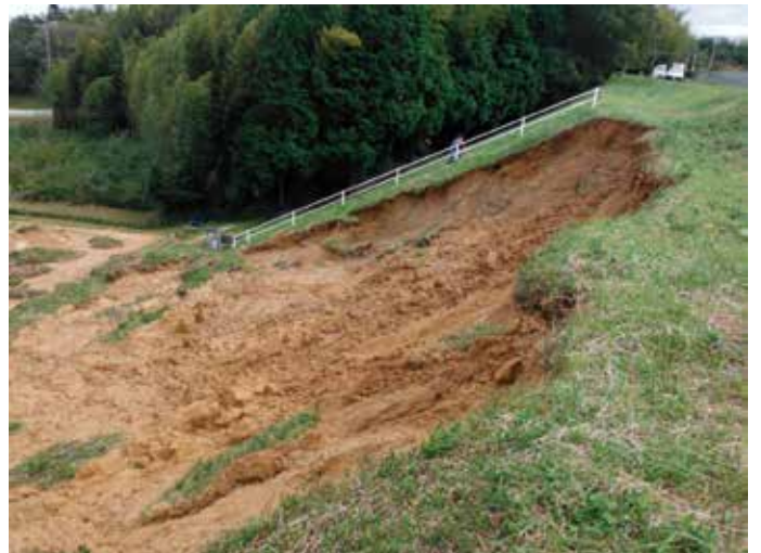
ため池堤体法面の崩落(松阪市伊勢寺町)
