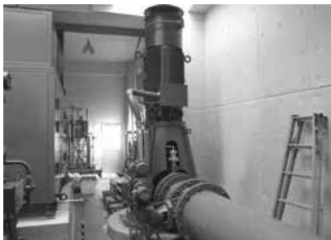
排水機（ポンプ本体）
