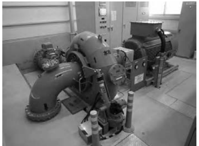
水車及び発電機
