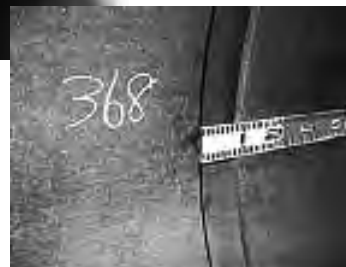
管水路の継手開き
