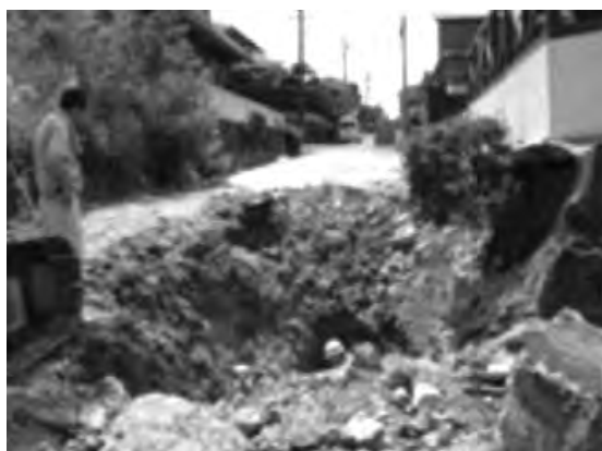
写真-1 富貴ヶ丘サイホン破裂による道路陥没状況 (H21.8.11発生)
