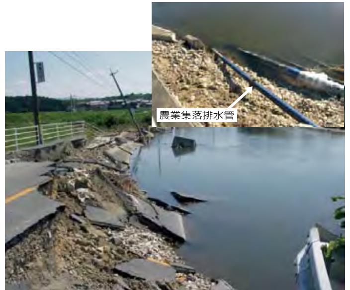
農業集落排水管の損壊 (伊賀市 国道 422 号)
