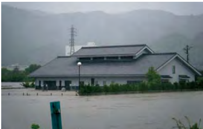
農業集落排水処理施設の冠水状況 (伊賀市 三田)
