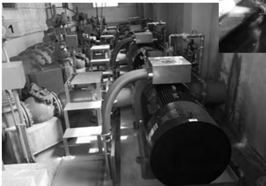
神田二期地区で更新された第2揚水機場のポンプ
