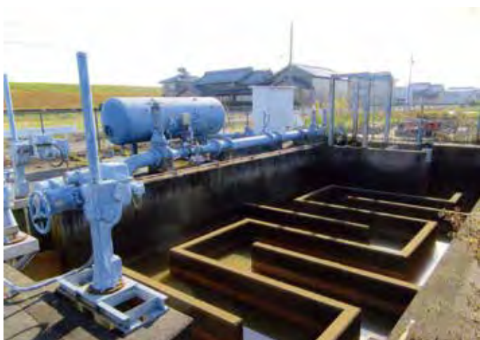
上之郷揚水機場
