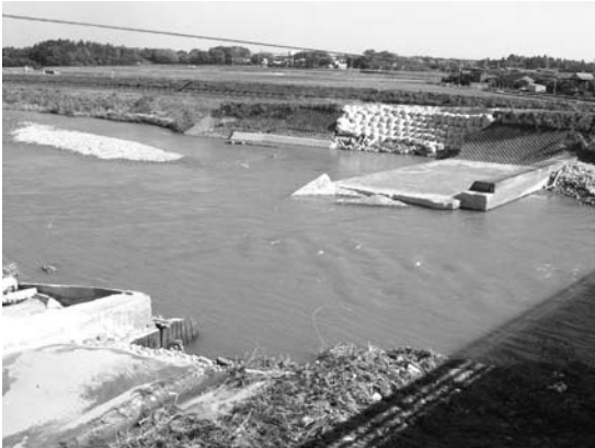
三郷井堰の全景(被災後)
